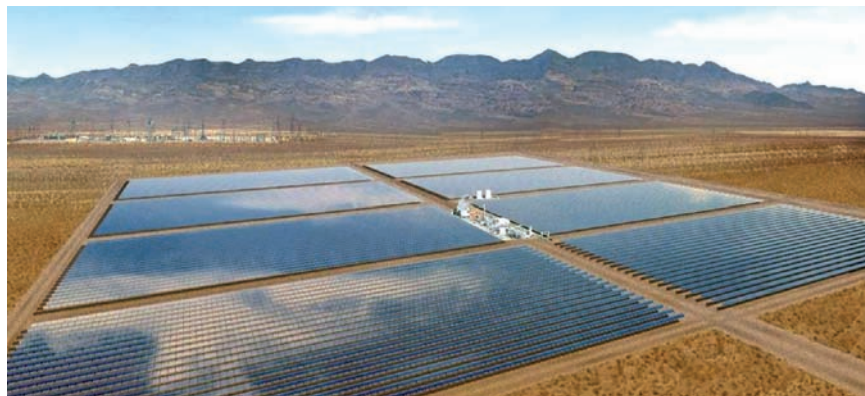
Figura 8. Planta Acciona-Solargenix de 64 MWe situada en Boulder, Nevada.
